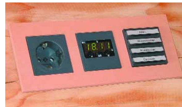
Über das Bussystem werden die Alarmanlage, Rolläden und die Heizung gesteuert.
